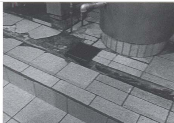
ZONA CENTRAL DE AREA DE COCINAS BASES DAÑADAS DE EQUIPOS
