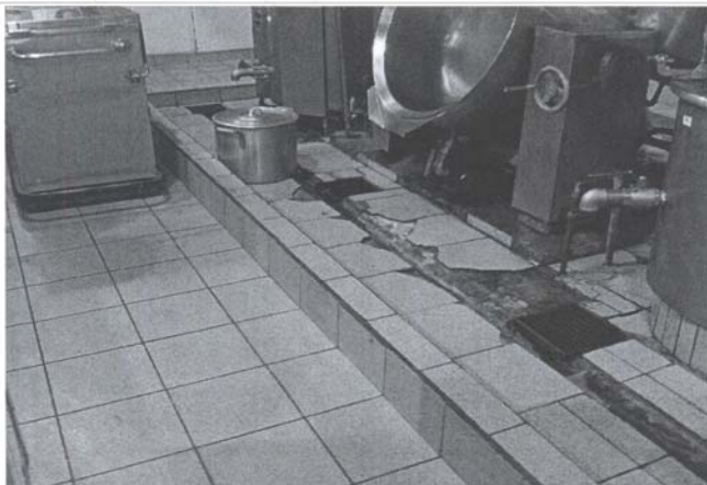
ZONA DAÑADA DE CANALETAS
