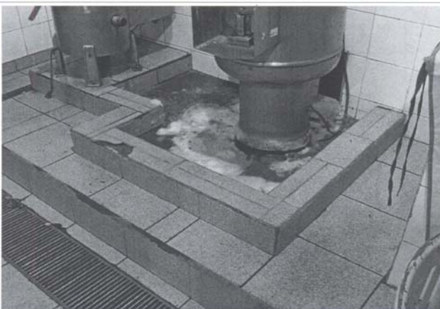
SARDINELES EN ZONA DE LICUADORAS INDUSTRIALES QUE SERAN REVESTIDOS CON PISO STONHARD
